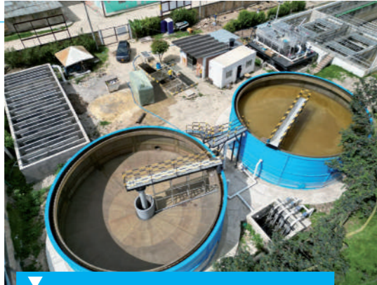
▶ PTAR Porvenir Cundinamarca 30 LPS Lodos Activados
